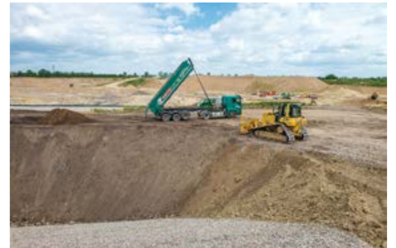
Eine streng überwachte Sicherheitskette gewährleistet, dass nur geeignetes Material in die Deponie eingebracht wird.
